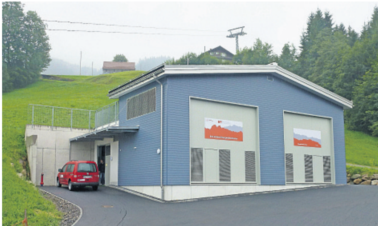
Die neue Unterstation Petersboden, wo die Stromspannung von 50 000 auf 15 000 Volt reduziert und danach in die Versorgungsgebiete verteilt wird. Bild EBS/EWS
